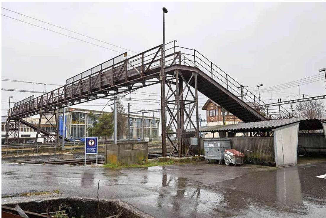
Die Passerelle bildet mit dem Stellwerk (hinter der Treppe) ein historisches Ensemble. Doch die Veloplätze mit Wellblech stören, findet der Verein Passerelle Kerzers.
